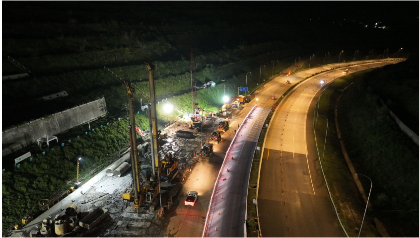
Penanganan Pergerakan Tanah di Jalan Tol Cisumdawu
