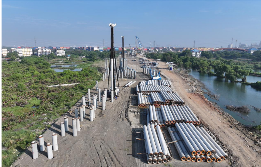
Tiang Pancang WIKA Beton Untuk Proyek New Priok Eastern Access
